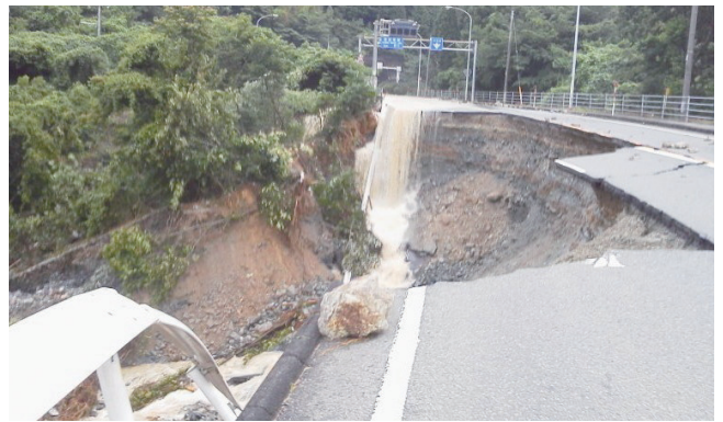
国道 191 号線が崩落
