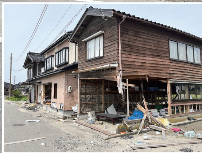
津波で1階部分が柱ごと押し流された家屋
