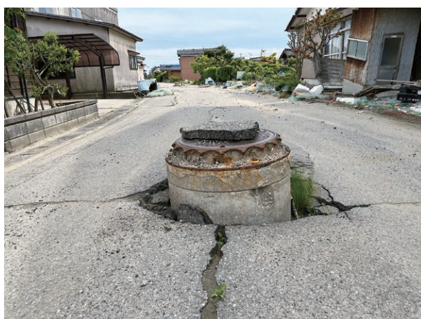
液状化の影響でマンホールが剥き出しになっている珠洲市宝立町の様子
